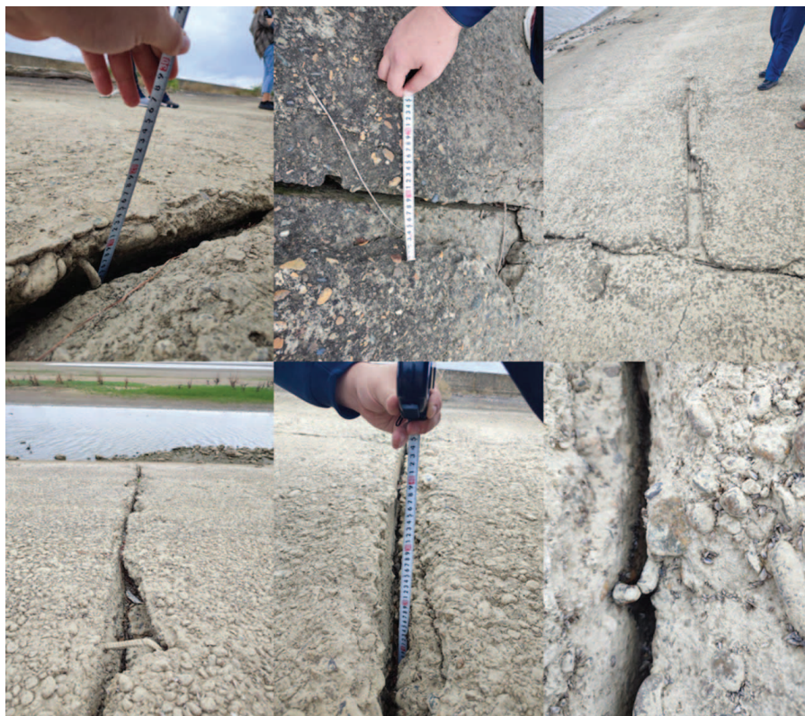
Рисунок 6. Типичные разрушения швов на оградительной плотине инженерной защиты долины р. Псекупс, Краснодарского водохранилища Figure 6. Typical destruction of seams on the protective dam of engineering protection of the valley of the Psekups river, Krasnodar reservoir
